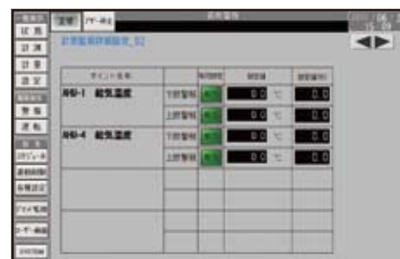
計測監視詳細設定
